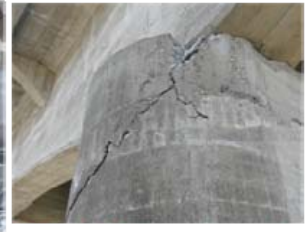
③ 桁・橋脚にクラック
