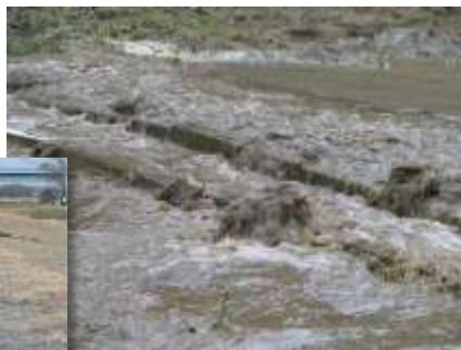
高水敷の液状化
