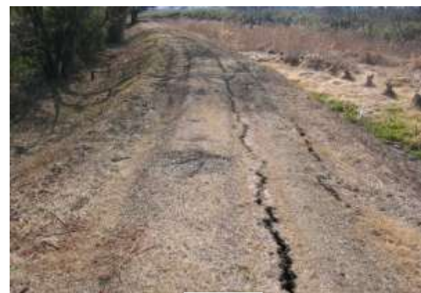
那珂川 [那珂川町国山地先] 堤防亀裂
