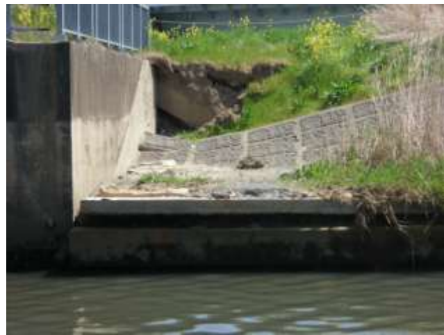
水門の取り付け護岸の被災 (水戸市、内川水門【那珂川】)
