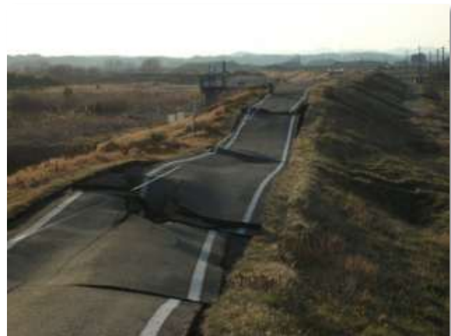
堤防の沈下 (常陸太田市落合地先【久慈川水系里川】)
