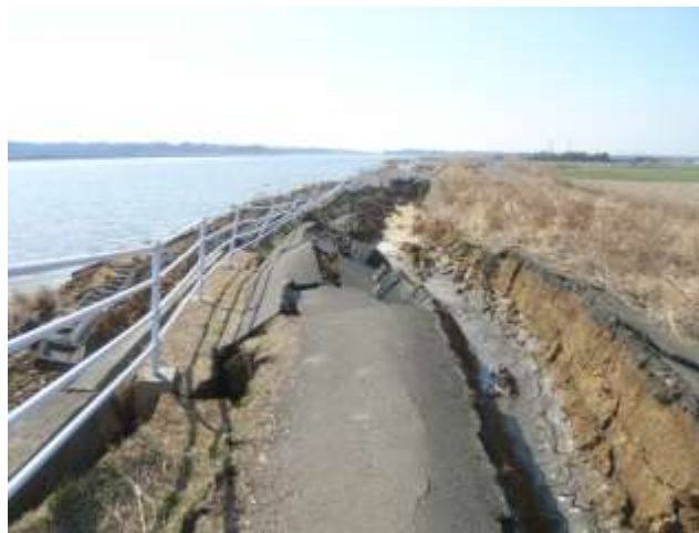
堤防の沈下 (茨城町下石崎地先【那珂川水系涸沼川】)
