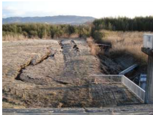
樋管の水路に生じた被災 (東海村、後川排水樋管【久慈川】)
