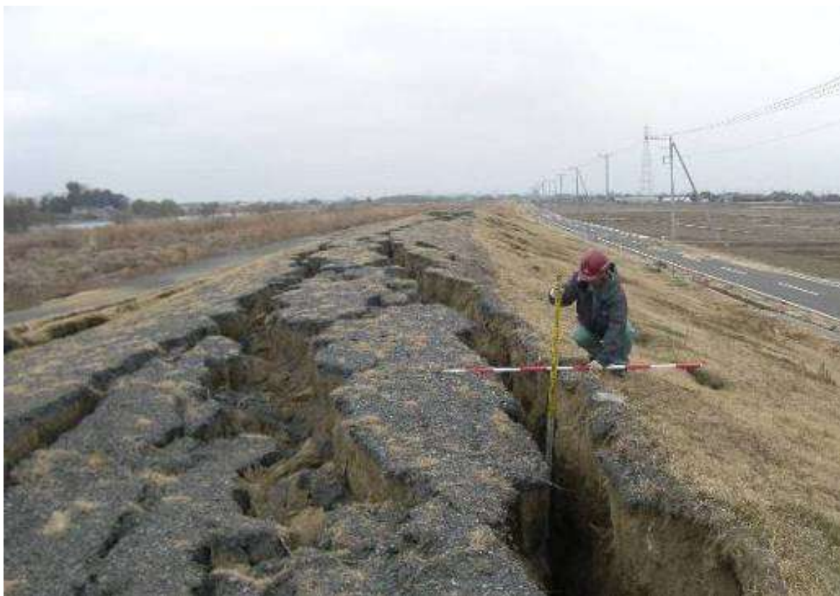
堤防の亀裂 （ひたちなか市三反田地先【那珂川】）
