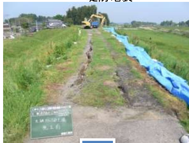
久慈川水系山田川 [常陸太田市栗原町地先] 堤防亀裂
