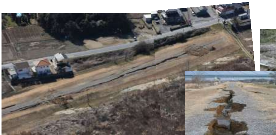
堤防の亀裂 (水戸市大野地先【那珂川】)
