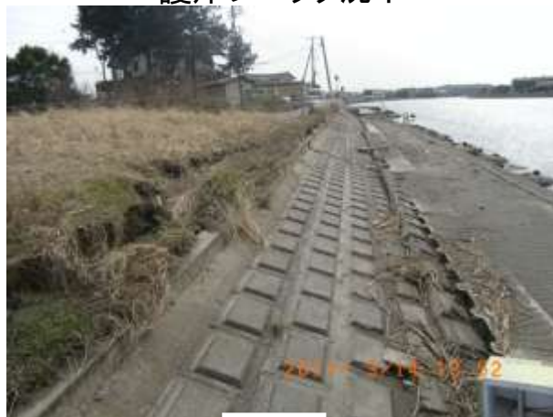
湍沼川 [大洗町磯浜町地先] 護岸ブロック沈下
