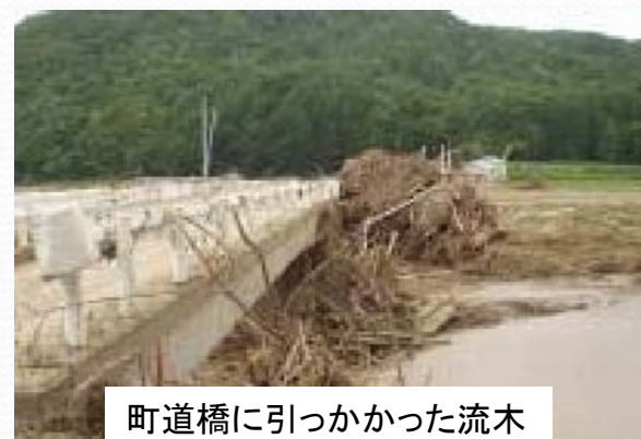
道路橋に引っかかった流木
