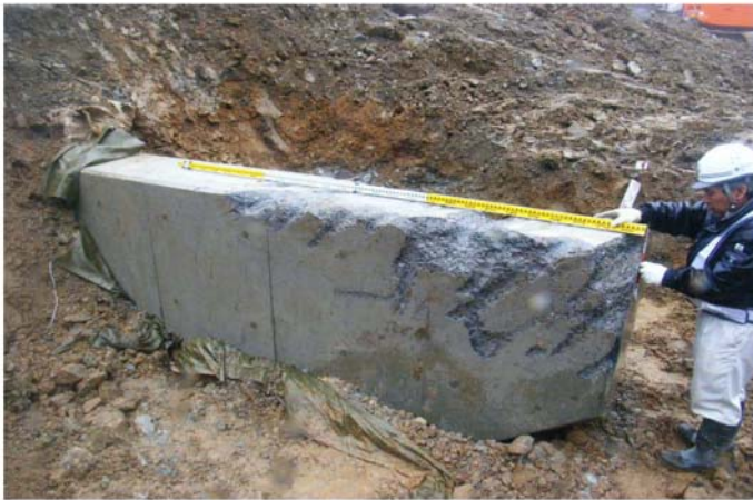
ウイング上流側破損状況
