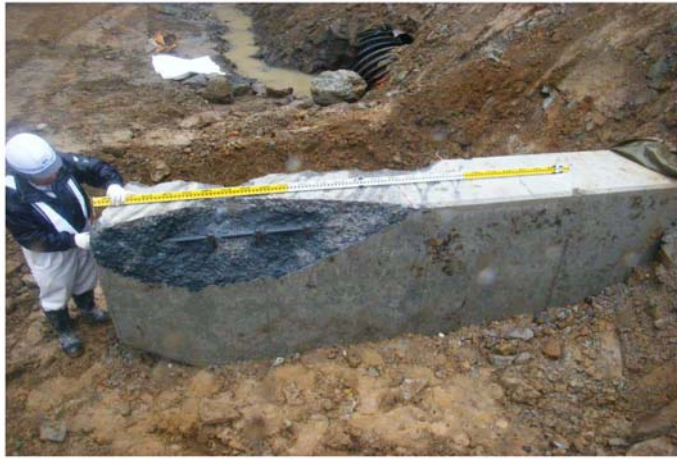
ウイング下流側破損状況
