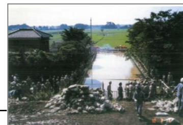
●千葉県印旛郡栄町漏水状況 (S57)
