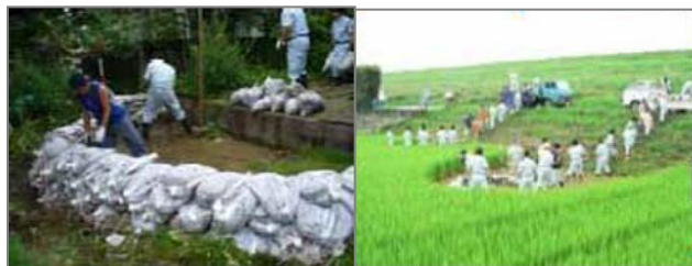
●埼玉県加須市漏水状況 (旧北川辺町) (H18)
