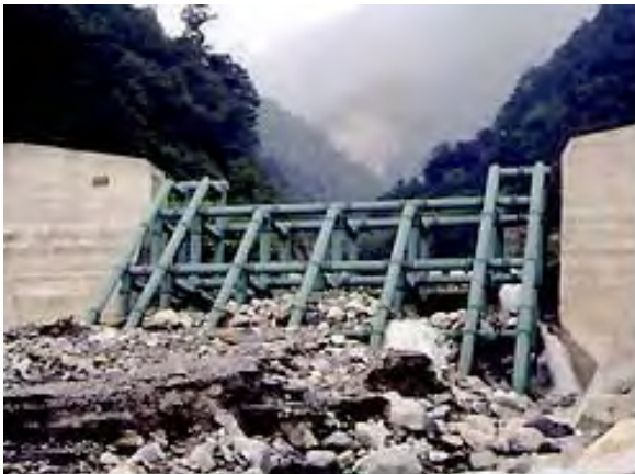
写真 3-1 鉄格子型砂防えん堤
