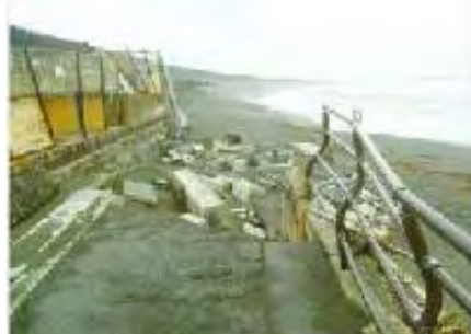
写真 3-7 平成 19 年台風 9 号被災事例
