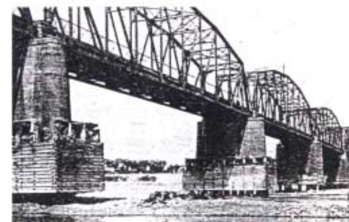
写真 1-4 基礎杭まで露出した旧相模橋
