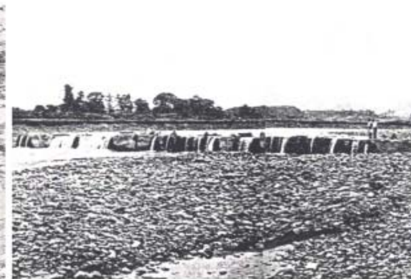
写真 1-2 サイフォンが露出した磯部頭首工
