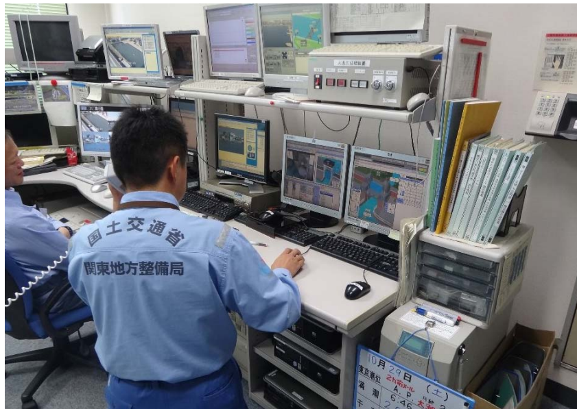
京浜河川事務所 災害対策室 (遠隔操作状況)
