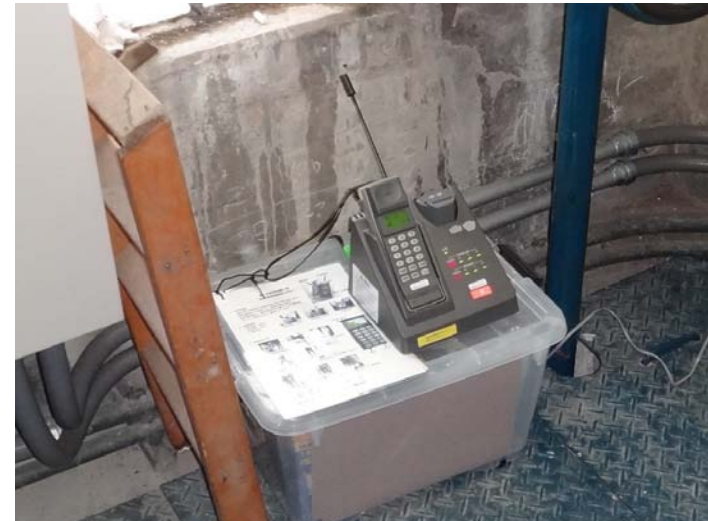
K-COSMOS(無線通信装置)の配備
