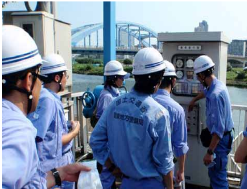
訓練全景(操作盤の確認)
