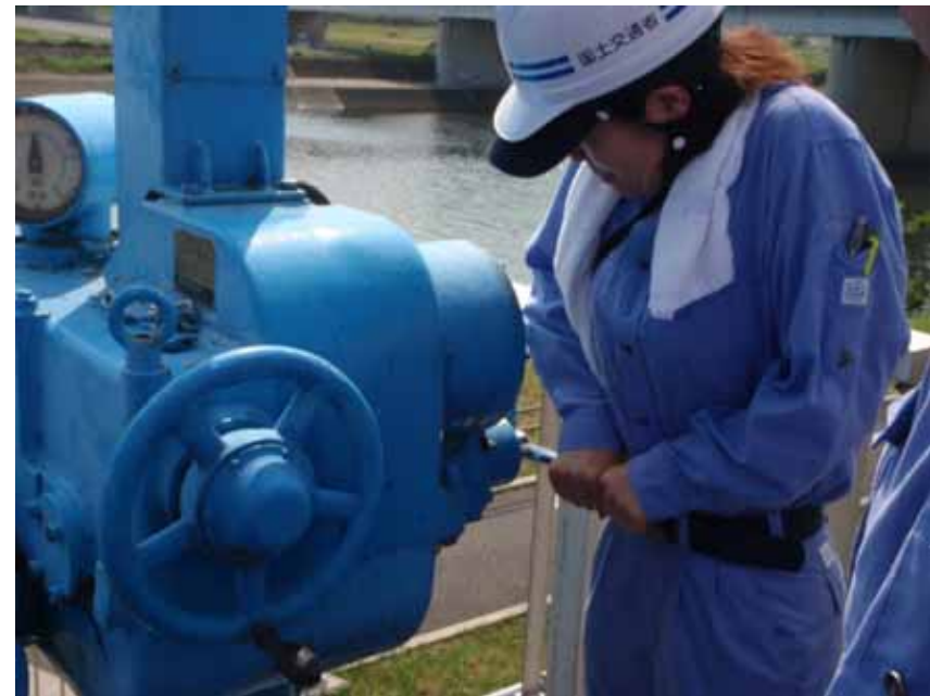
停電時操作(手動レバーによる急速閉鎖)
