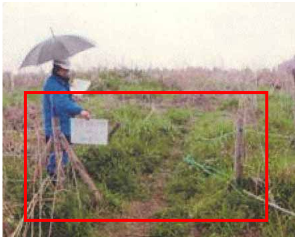
柵が損傷し、進入可能な状態になっていました。
