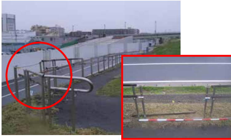
スロープの手摺が破損していました。
