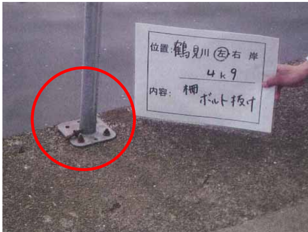
ボルトが抜け、支柱がぐらついていました。
