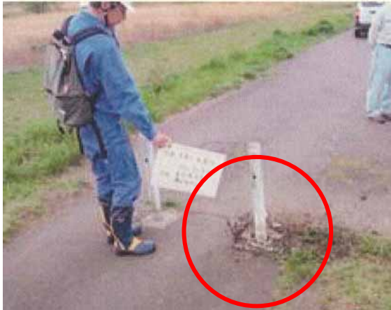
車止めが破損し、不安定な状態でした。
