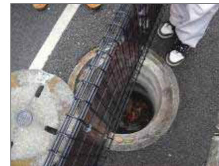
昭島つつじヶ丘ハイツ 浸透工法団地
