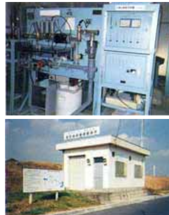
水質自動監視装置
