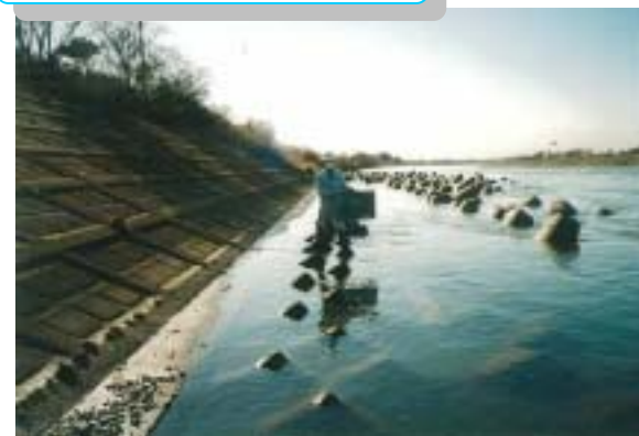
写真 河床低下による堤防護岸の露出状況（相模川 19.0k 左岸）
