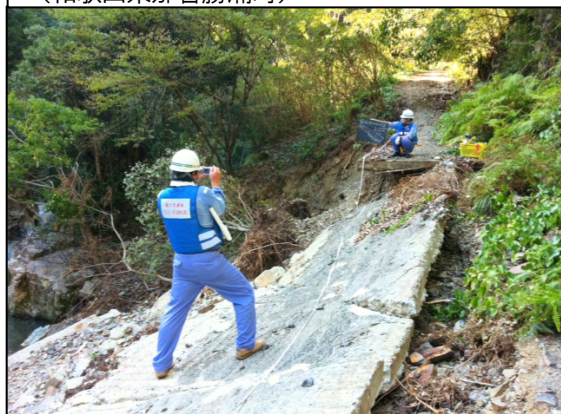
坂路崩壊の被災調査【和田川】 (和歌山県新宮市)
