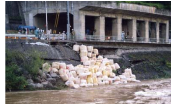
H14.7.10 台風による道路決壊 南牧村海ノ口 24時間通行止
