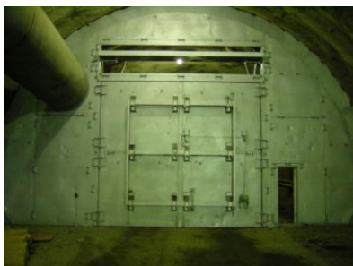
写真 3-2-3 防音扉の状況
