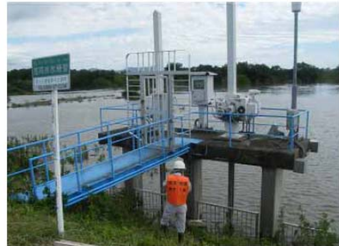
小貝川右岸48k付近 浅間排水樋管（下妻市） 状況把握（22日11:30頃）
