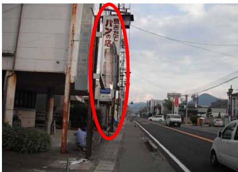
看板損傷状況
