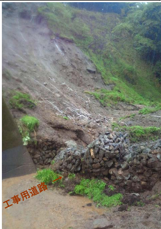
稲荷川工事用道路 法面崩落
