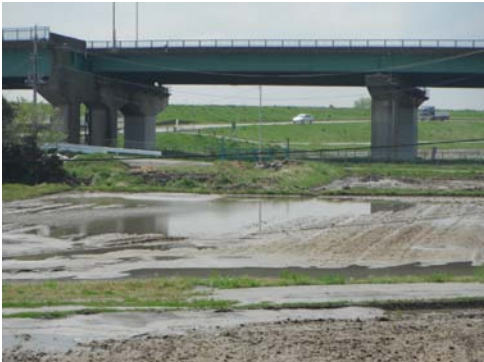
古関潤一（東京大学）2011/3/19 横利根水門付近
