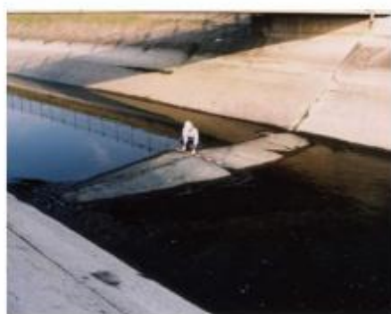
写真-水路の段差の発生状況
