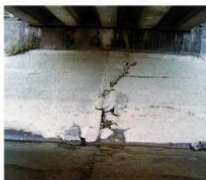
写真-水路コンクリートの損傷状況
