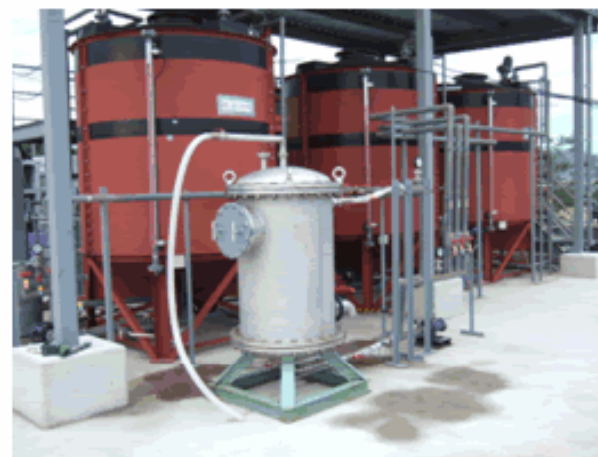
■工場の排水処理施設の事例
