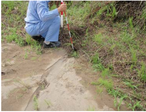
【モグラ穴による土砂流出】
