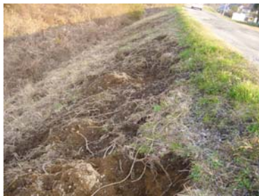
【堤防被害・深さ最大40cm】
