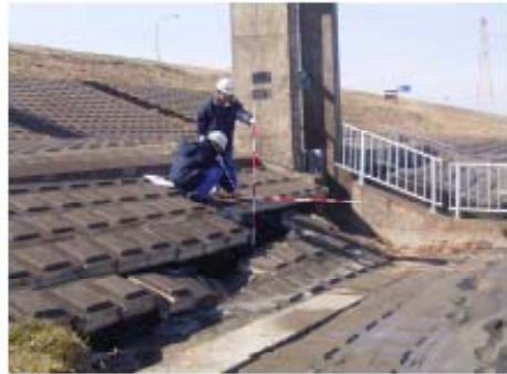
護岸陥没(神崎樋管)
