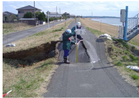
抜け上がり(息栖樋管)
