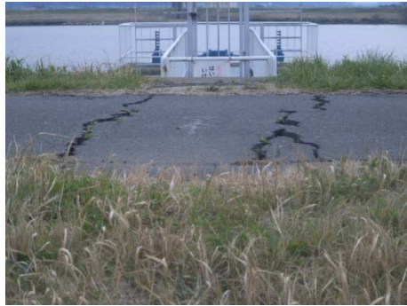
抜け上がり(飯島樋管)
