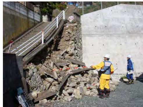
TEC-FORCE による急傾斜地調査（茨城県） ※茨城県日立市会瀬町
