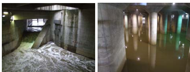
洪水が地下施設に流入している様子
