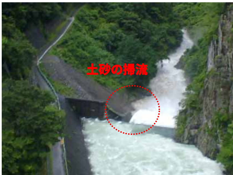
土砂掃流の状況（副ダム直下流）：H18年7月撮影
