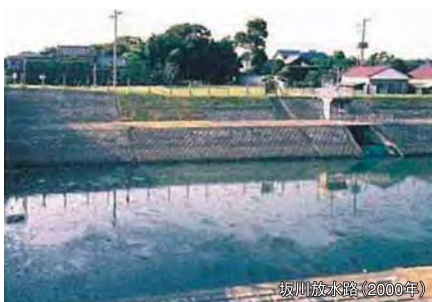
坂川放水路（2000年）
