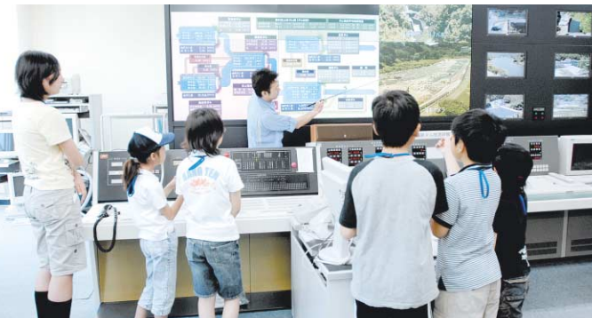
いろいろな機械が並ぶダムをコントロールしている制御室
