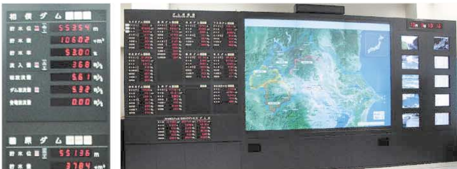
事務所の中の大型情報表示板。ダムや河川などの現在の情報がひとめでわかる
