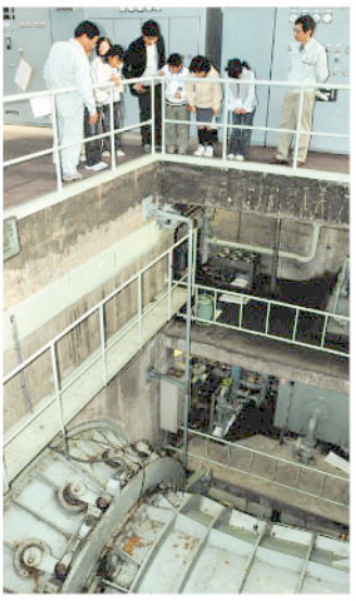
田口発電所の中。下で水車が回っている
