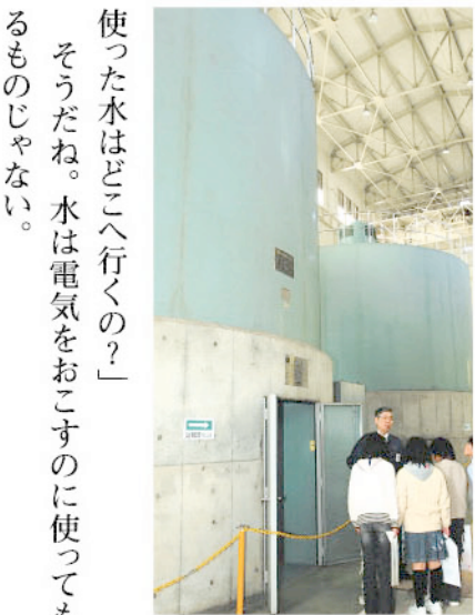
みんなで佐久発電所の中を見学! この円筒の中で水車が回っている
