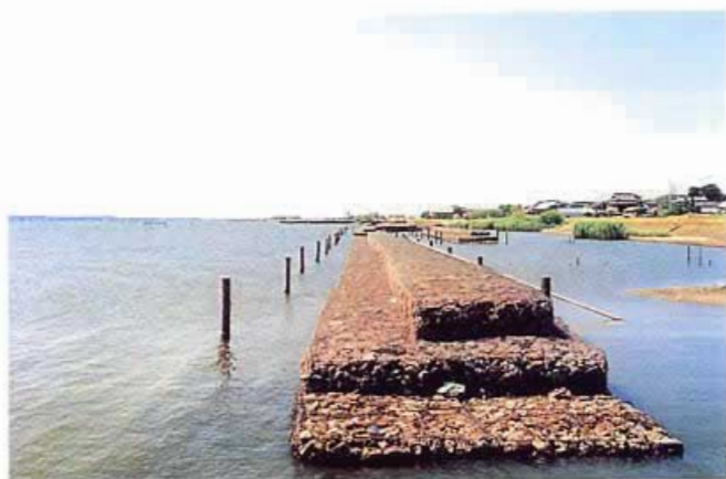
▲五町田地区波浪対策（カゴマットを使用した離岸堤）
