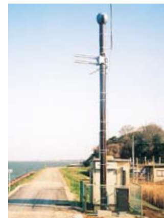
▲CCTVカメラ設備
