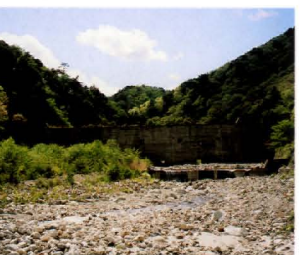
⑮ 小妻川第一砂防えん堤 Komikawa No.1 Sabo dam 昭和34年災害の直後に建設された大規模砂防えん堤で、昭和57年出水で調節効果を発揮した。 The large underdrain sabo dam was constructed after the disaster in 1959. The dam well displayed the sediment control effect during the heavy rain in 1982.
