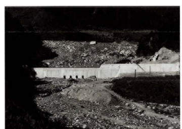
⑨ 大妻川砂防えん堤 Ohmukawa Sabo dam 昭和34年災害を受け、特殊緊急砂防事業として整備された砂防えん堤。 This sabo dam was constructed as a special emergency sabo work after the disaster in 1959.
