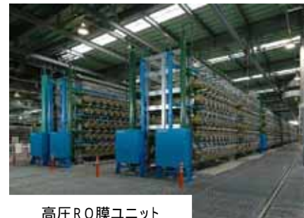
高圧RO膜ユニット
