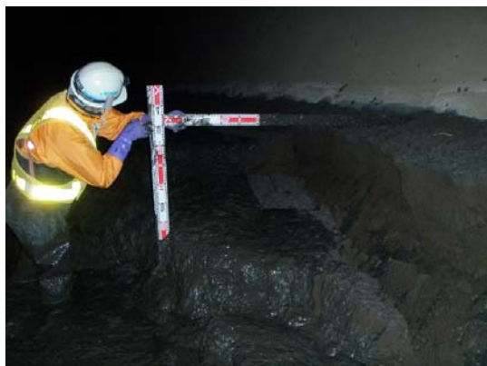
土砂堆積状況
