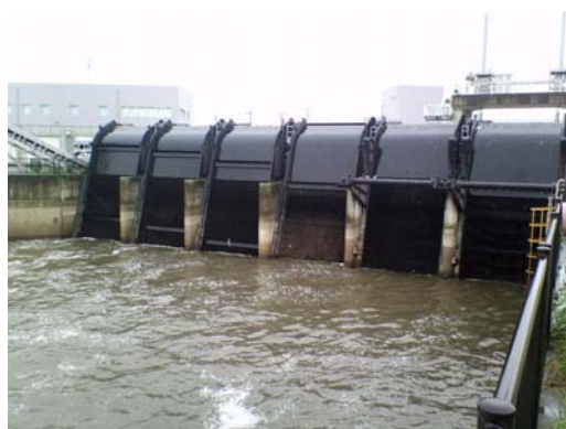
倉松川除塵機
