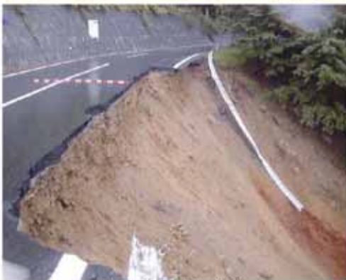
法面崩壊の発生状況
