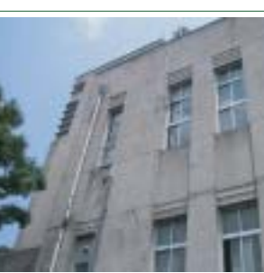
外壁に見られる数多くの補修跡
