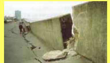
阪神淡路大震災の状況(淀川)
