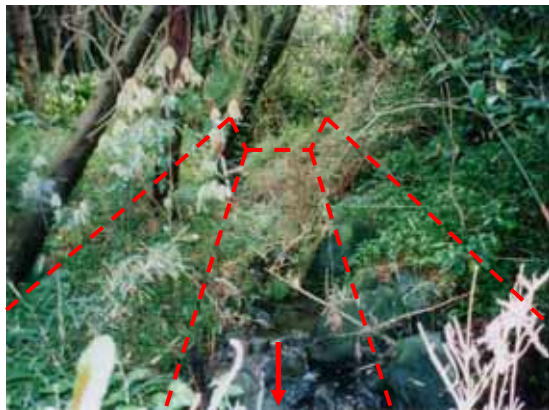
押し出され、水の流れを阻害している
