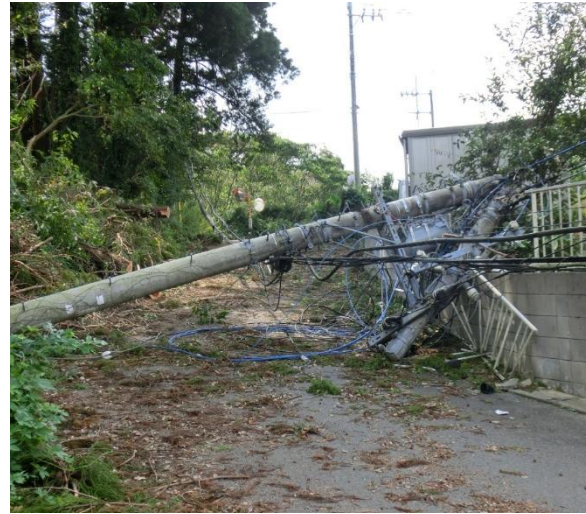
令和元年9月 千葉県山武市 山武市道
