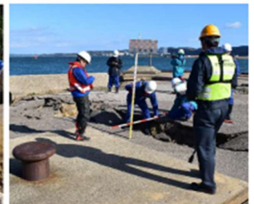
港湾被害状況の調査
