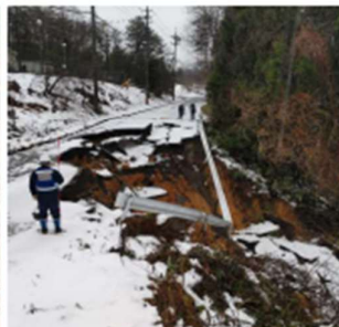
道路被害状況の調査
