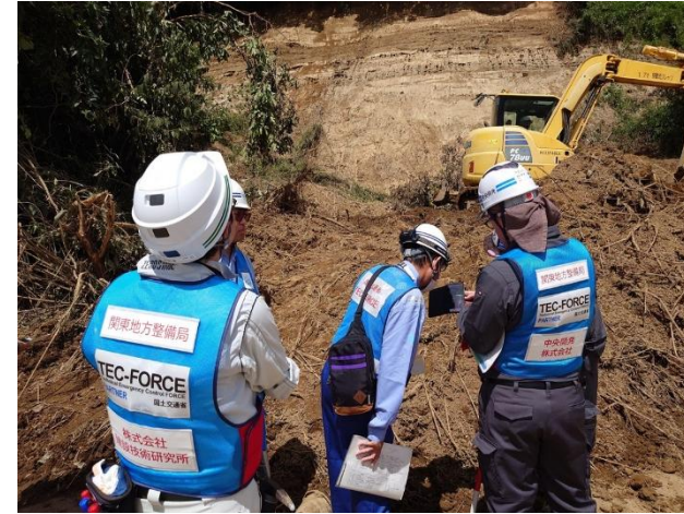
市原市 活動状況 TEC-FORCEパートナー 被災状況調査(中央開発 株式会社 ・ 株式会社 建設技術研究所)
