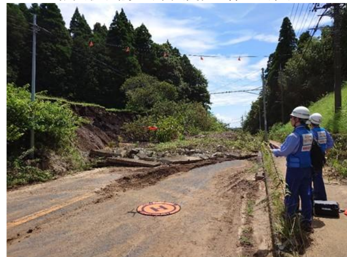
千葉市緑区 活動状況 被災状況調査班(ドローン班)
