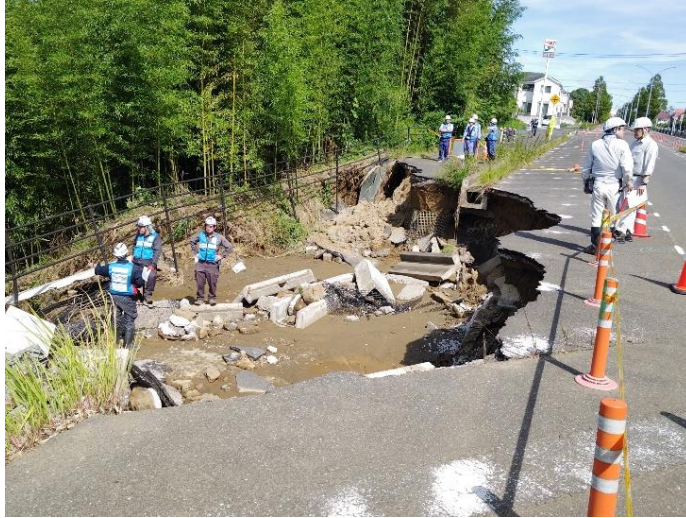
千葉市緑区 活動状況 TEC-FORCEパートナー 被災状況調査(中央開発 株式会社 ・ 株式会社 建設技術研究所)
