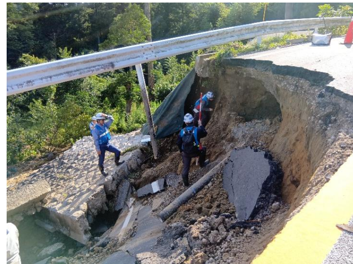
千葉市緑区 活動状況 TEC-FORCEパートナー 被災状況調査(中央開発 株式会社)
