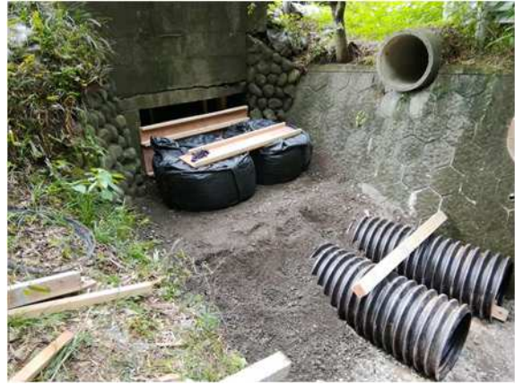
水路側面閉塞
