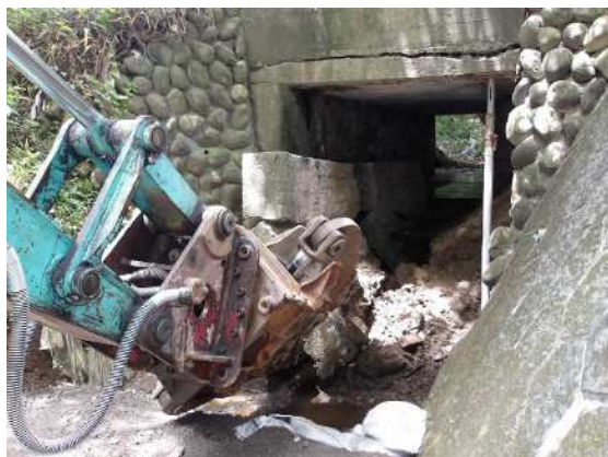
倒壊した側壁の引き出し
