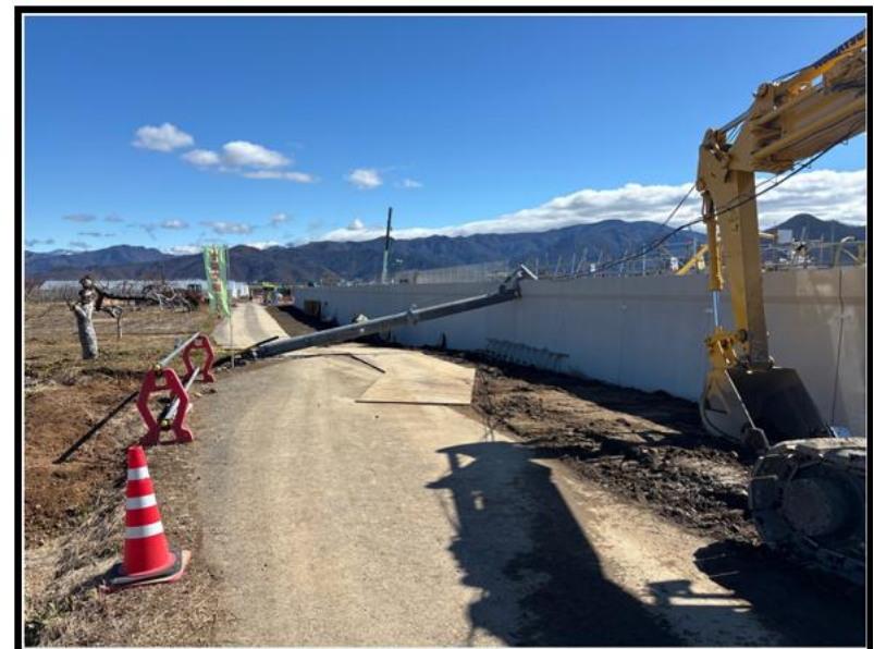
事故発生直後の電柱等損傷状況
