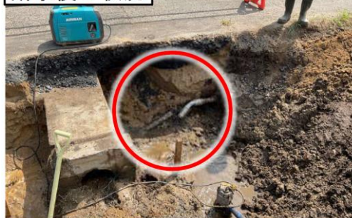
断水後の状況
