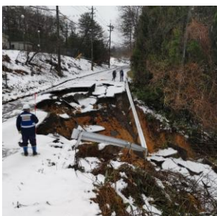
道路被害状況の調査
