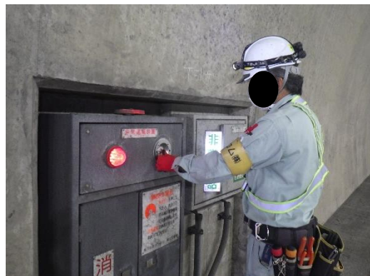
道路トンネル非常用装置点検
