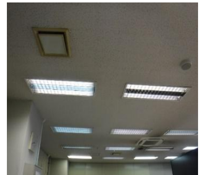
天井照明器具
