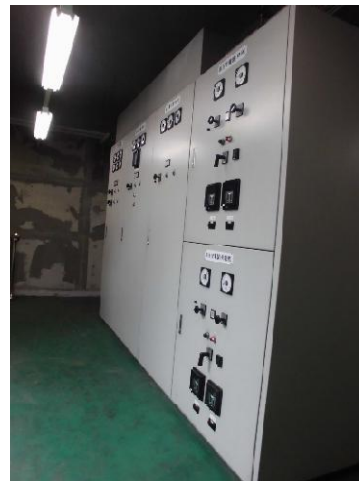
電気室（撤去対象のキュービクル）
